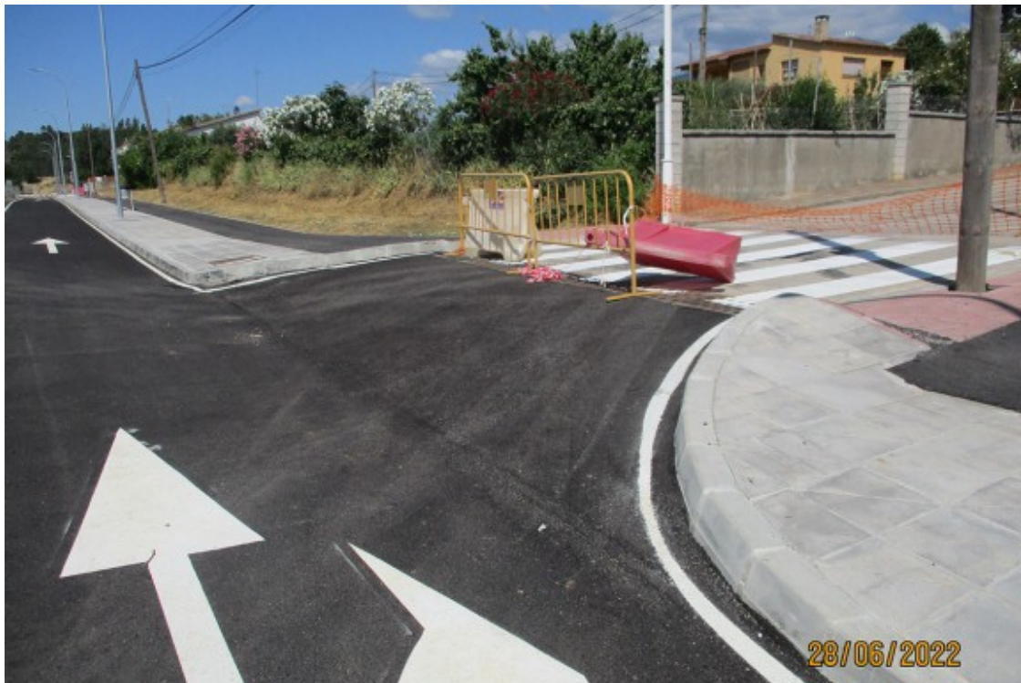
Les obres inacabades. Foto: Ajuntament de Riells i Viabrea
