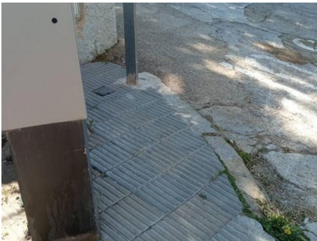
Barreres arquitectòniques en un carrer de Breda Foto: Vilatans Breda
