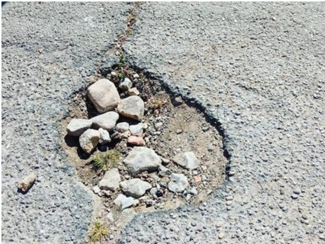
Un dels carrers de Breda en mal estat Foto: Vilatans Breda
